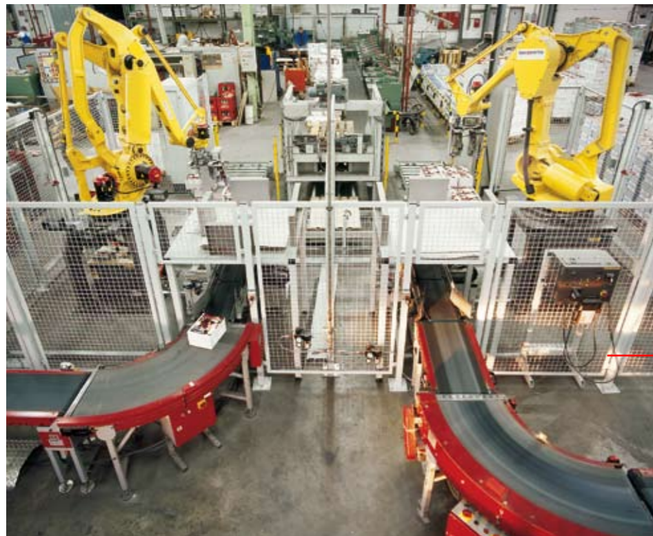
Die Pakete der zwei Klebebinderlinien werden über zwei Förderlinien zu den Aufnahme-Stationen der Palettierzelle geführt. Die beiden RS 400 Roboter nehmen die losen Stapel mit dem Doppelgreifer auf und setzen sie auf die automatisch angelieferten Paletten ab. Dabei kann die Palettierzelle bis zu 2000 Pakete/h verarbeiten.
