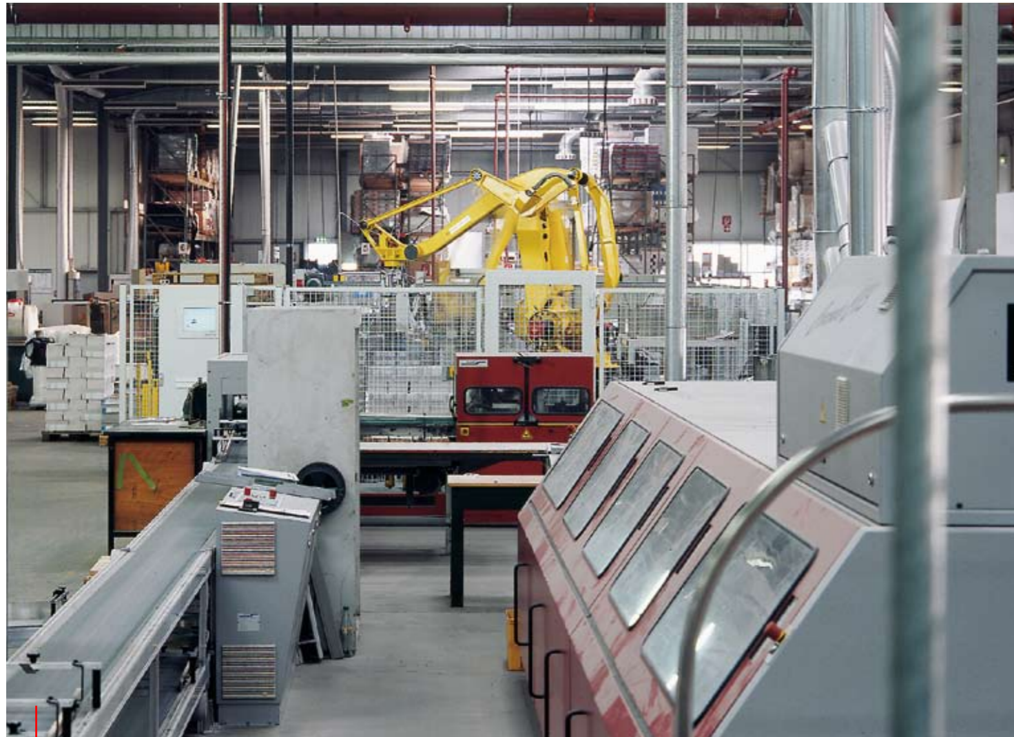
Die bereits bestehende Roboterzelle wurde kostengünstig durch die Installation eines zweiten RS 400 Palettierroboters erweitert. Jetzt ist die Weiterverarbeitung hinter zwei Klebebinderlinien mit einer Doppel-Roboter-Konfiguration komplett automatisiert.
