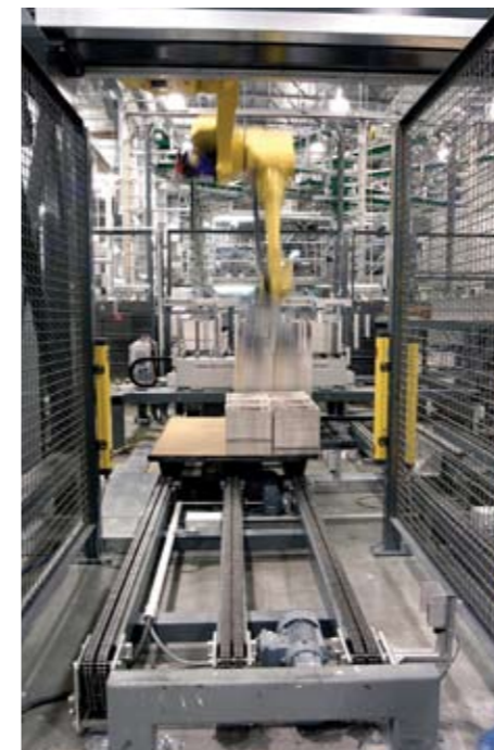
▲ Der RS 500 Roboter palettiert von vier Linien auf vier Paletten. Paletten-förderertechnik und Zwischenbogenzuführung erfolgen vollautomatisch. Falls notwendig kann auch nur ein Roboter (eventuell bei reduzierter Leistung) alle vier Linien bedie-
