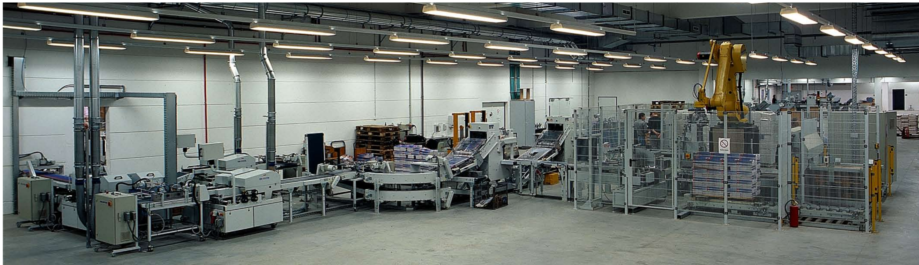
▲ Gesamtansicht der Weiterverarbeitung mit Heavy Duty Förderanlage, RS 820 Rotationsschneider, RS 25SN Zeitungskreuzleger und RS 400 Multifformat-Palettierer.
